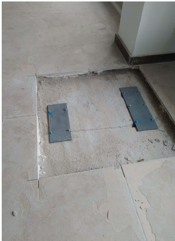
Abb. 14 Ertüchtigungsmaßnahme für Risse der Kategorie (d); Draufsicht Decken- oberseite mit ausgebauten Fliesen
